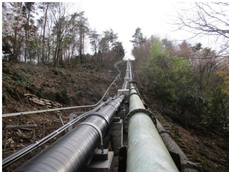
【更新後の水圧管】
